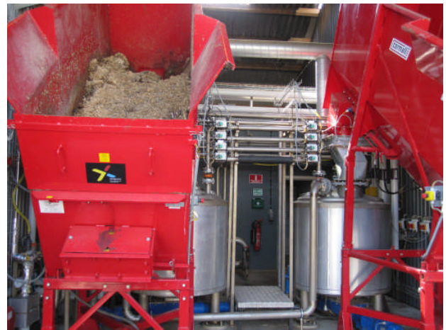
▲ふん尿とサイレージを混ぜバイオガスを発生
